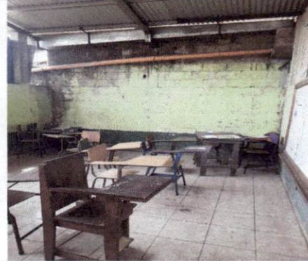
Foto 2: Paredes sin repello, pintura y filtradas de agua por canales deteriorados.
