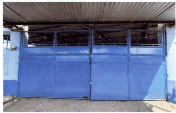
Foto 4: Puertas deterioradas, oxidadas y picadas.
