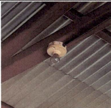
Foto 5: Focos sin funcionar.
