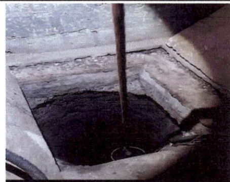
Foto 6: Bomba de agua deteriorada. Pozo sin agua.
